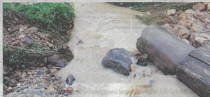
Jambatan kayu yang menghubungkan perkampungan Orang Asli di Pos Pasik, Gua Musang, Kelantan runtuh akibat hujan lebat.
