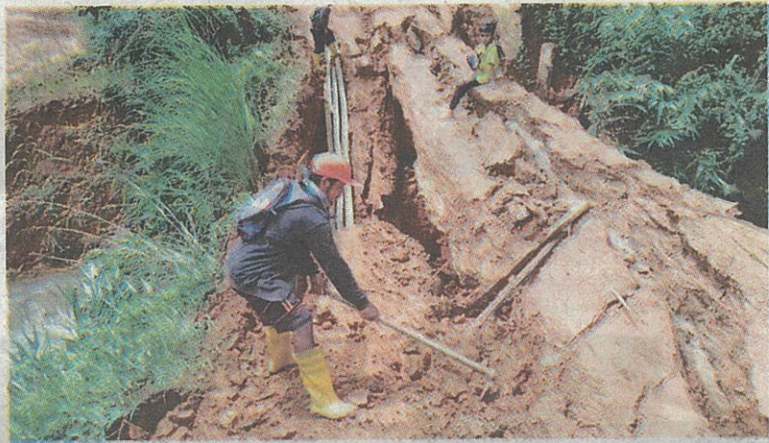
PENDUDUK Orang Asli membaiki jambatan kayu yang runtuh pada musim tengkujuh di Pos Bihai, Gua Musang baru-baru ini.
