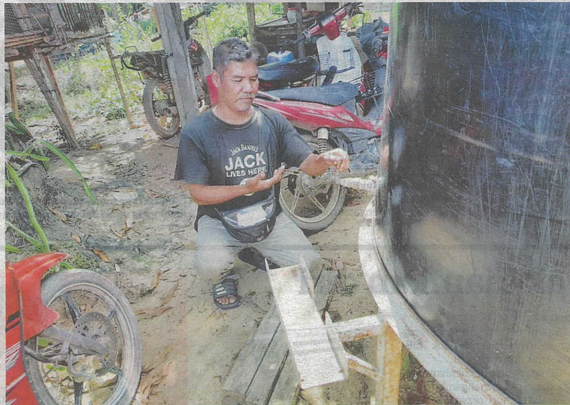
SEORANG penduduk Orang Asli, Muzalan Dolah menunjukkan paip air dari tangki yang sudah tidak mengeluarkan air selepas pam di kampung mereka rosak sejak tujuh bulan lalu.
