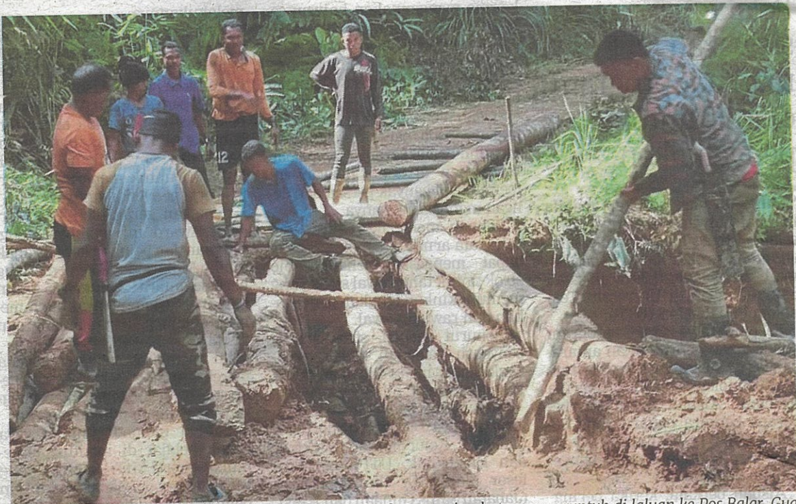
Sekumpulan Orang Asli membina semula satu daripada empat jambatan yang runtuh di laluan ke Pos Balar, Gua Musang. (Foto Ramli Ibrahim/BH)
